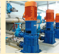
▲ Wenn eine Wassergewinnung mittels Gravi- tation nicht möglich ist, versorgen Pumpwerke die Haushalte mit Wasser. Sie können auch bei der Trinkwasserförderung aus Brunnen zum Einsatz.
